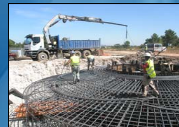
Parque Eólico de Páramo de Pozas
