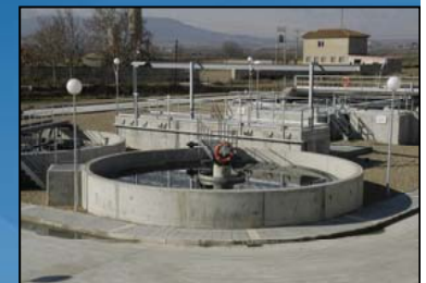
EDAR Mallen (Zaragoza)
